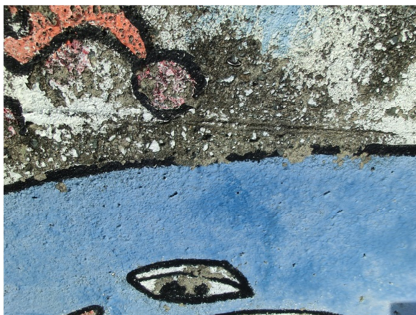
15 年以上経過した壁面。コンクリート面の風化によって絵具の剥離が著しい。
